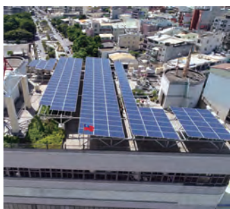
公有設施類建築： 楠梓區公所(56.68 kwp)
